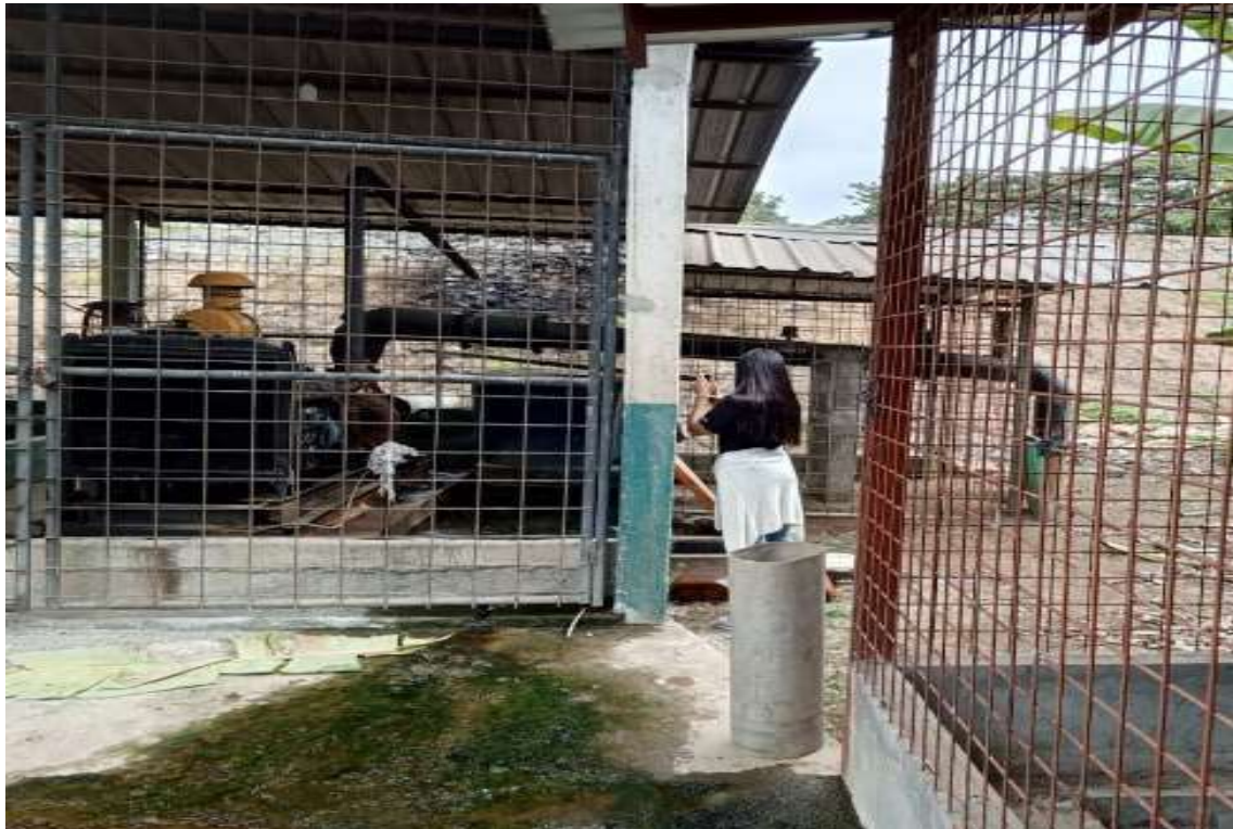
Figura 22. Estación de bombeo de la finca
